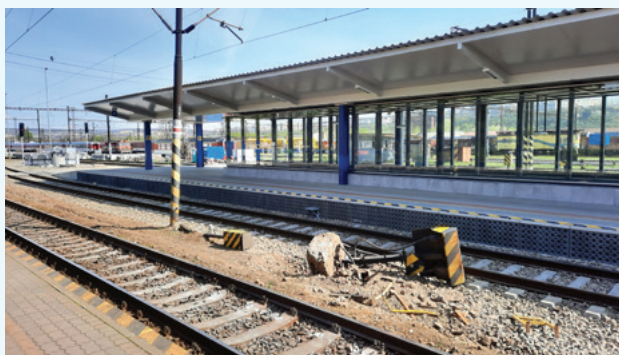
OR KE: Výmena naklonenej trakčnej podpory č. 39 v ŽST Košice — po nehode
