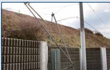
Rýchlik na 700-metrovom úseku strhol trakčné vedenie a poškodil izolátory a ramená podpier.
