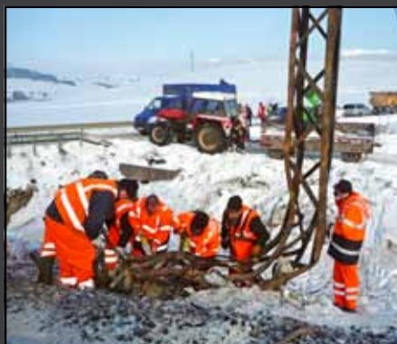
Po tragickej nehode vlaku a posypového vozidla zostala poškodená koľaj, trakčná podpera, trakčné vedenie. Na koľaji bol lom aj vybočenie.
