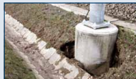
Pravdepodobným zdrojom poškodenia trolejového vedenia bola podmytá podpera č. 109.
