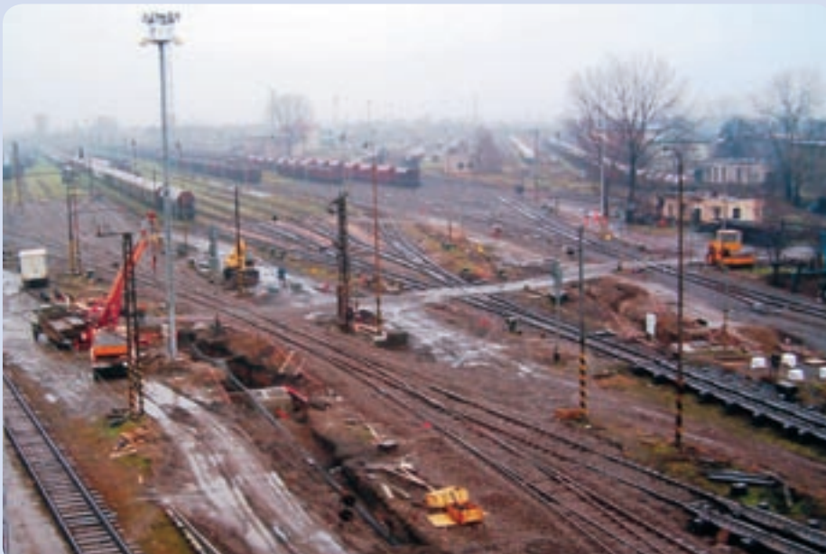
Iba málokterá železničná stanica je taká rozsiahla ako Čierna nad Tisou. Desiat' kilometrov štvorcových a dva rôzne rozchody si zaslúžia kvalitné technické vybavenie, na ktorom sa aj v týchto dňoch pracuje.
