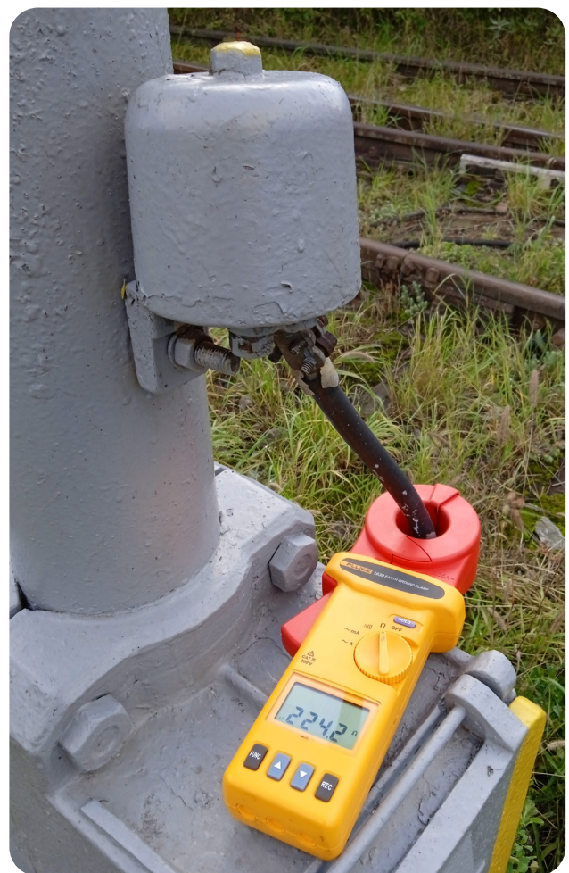
Meranie izolačného stavu prierazky prístrojom Fluke1630.+
