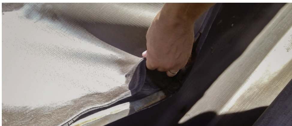
Degradácia krytiny, oblúčková strecha veľkého vestibulu — pôvodný stav.
