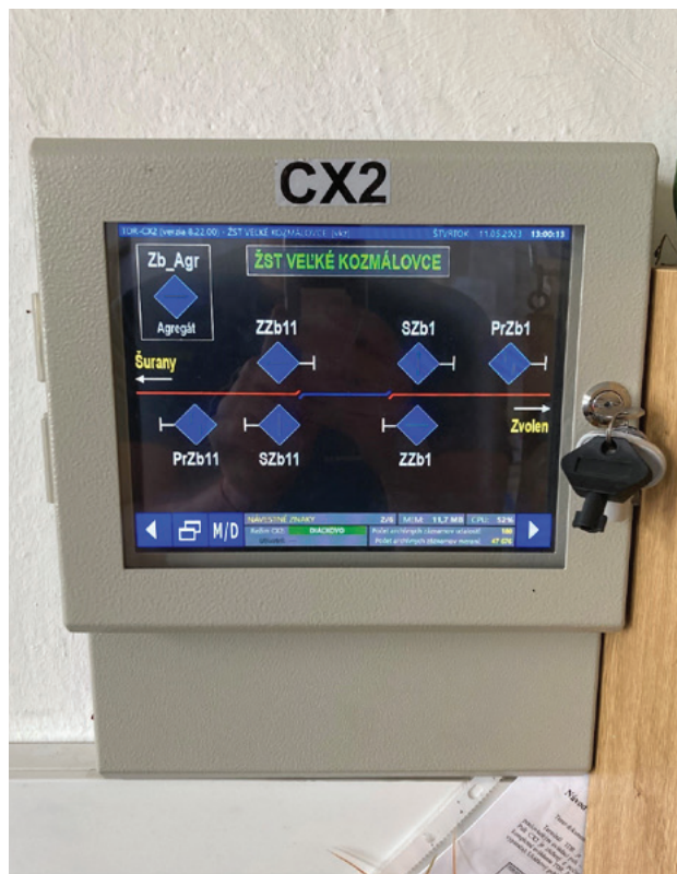
Pohľad na riadiacu jednotku CX2 zariadenia TDR inštalovaného v kancelárii výpravcu.
